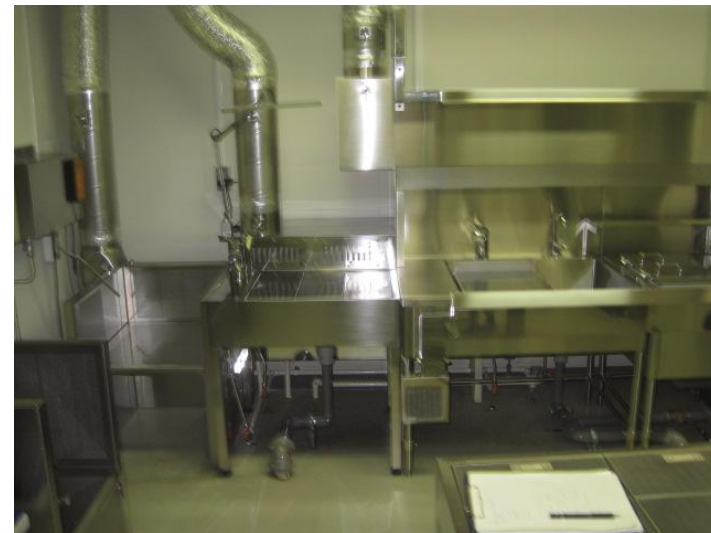
東京都内某病院 病理検査室導入機器 (新築案件)
